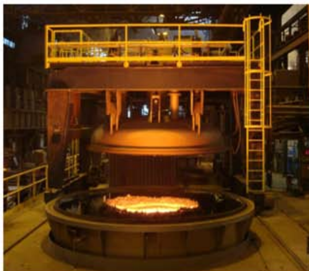
Установка вакуумно-кислородного обезуглероживания
